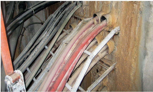
Stato della condotta sotterranea prima del risanamento: l'acqua è passata tra i tubi di protezione e i cavi, oltre che tra i tubi di protezione e il muro.
