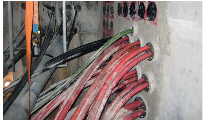
Stato della condotta sotterranea dopo il risanamento: sono stati realizzati dei passaggi di riserva. Intorno ai cavi posati sono stati montati dei tubi di rivestimento divisi. È stato così possibile garantire la tenuta del muro dai tubi di rivestimento fino ai cavi.
